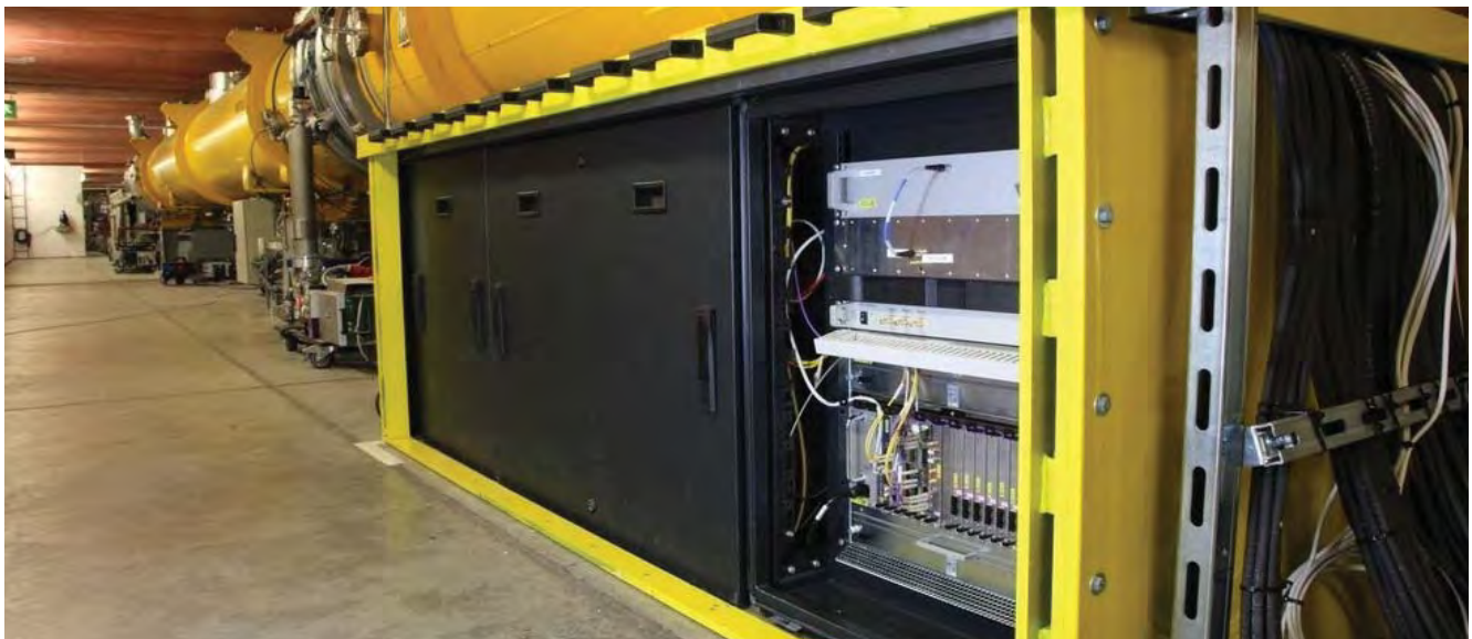
Abb.: Vollfunktionsfähiges Timing/LLRF Steuersystem auf Basis von MTCA.4 installiert in FLASH. Erzeugung von ultra-kurzen Laserblitzen (4,1 nm).
